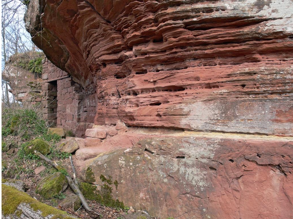
Verwitterungsspuren am Château de Rothenbourg (Tour 7)
