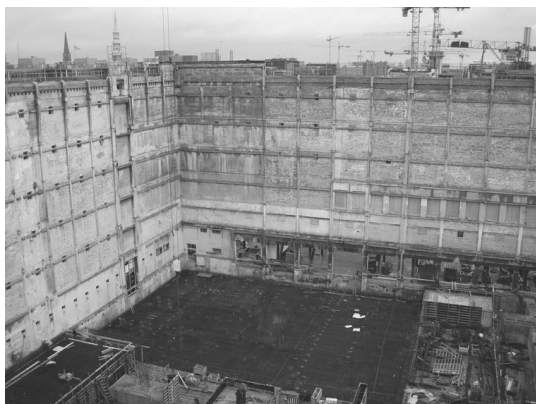
a) Mauerwerkshülle des ehemaligen Kaispeichers A (1965) in Hamburg nach Entfernung des inneren Skeletts
