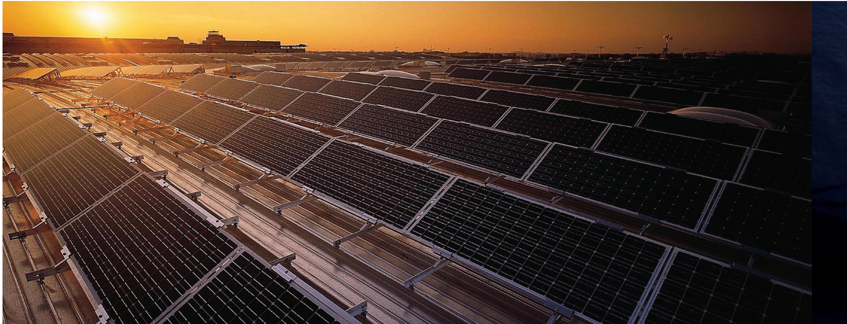
Die große Photovoltaik-Dachanlage auf der Münchner Messe hat eine Nennleistung von rund 1 MW el (Foto: Shell Solar).
