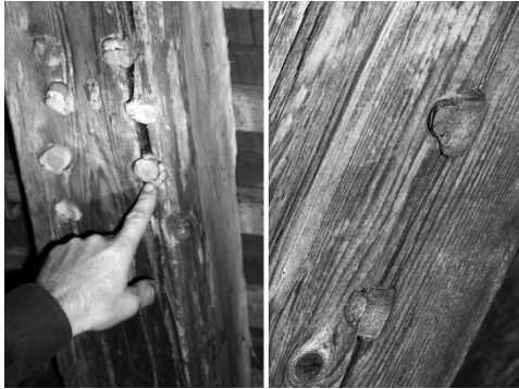
Bild 2.5 Floßkeile mit Resten der im Bohrloch verkeilten Wieden (Frauenkirche Günzburg und Hofgut Öttershausen, 18. Jh.).
