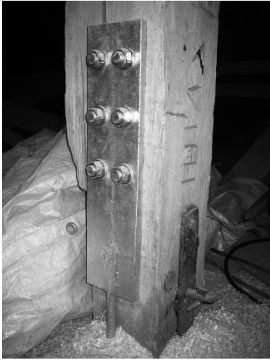
Bild 1.4 Maßstabsprengende „Reparatur“ eines völlig unbeschädigten historischen Anschlusses.
