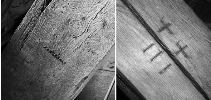
Bild 2.1 Verbautes Eichenholz (links; Klosterkirche Corvey, 17. Jh.) und Nadelholz (rechts, Salvatorkirche München, Ende 15. Jh.) im Vergleich. Man beachte die Abbundmarken und den Schwindriss.
