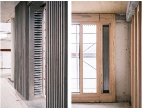
Abbildung 3: Außen- und Innenansicht der fensterhohen Lüftungskammern, welche die Wohnungen auf natürliche Art und Weise mit Frischluft versorgen © P.W.S.
