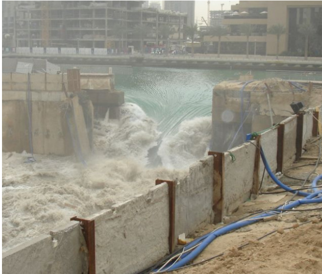
Abbildung 1.1: mögen solche Baugrubensituationen vermieden werden
