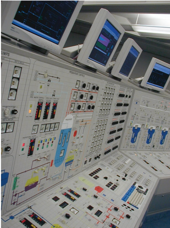
Рис. 1.1 ❖ Часть главного пульта управления водо-водяного реактора (PWR)
