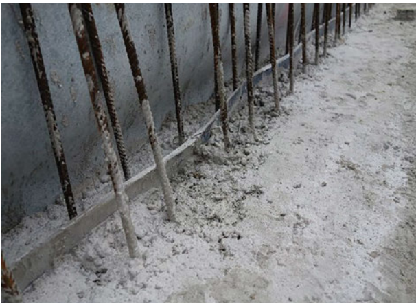
Abb. 1: Unsauber hergestellte WU-Fuge am Übergang zwischen Bodenplatte und Außenwand mit verschmutztem und nicht geradlinig verlegtem Fugenband
