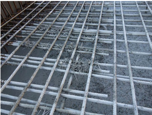
Abb. 2: Entmischungen/Fasernester des Stahlfaserbetons einer WU-Bodenplatte im Bereich der oberen Bewehrungslage
