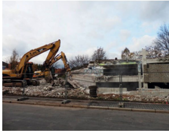
Abb. 1: Abriss eines Parkhauses nach einem Lebenszyklus von nur 35 Jahren.
