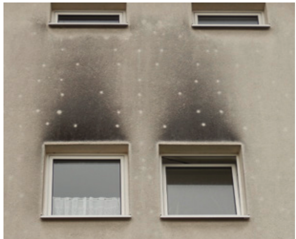
Abb. 2: Mehrfamilienhaus aus den 1970er-Jahren, Anfang der 2000er-Jahre mit Polystyrol gedämmt: Hier wird deutlich sichtbar, dass die Kipplüftung den mikrobiologischen Befall an der Fassade stark begünstigt.
