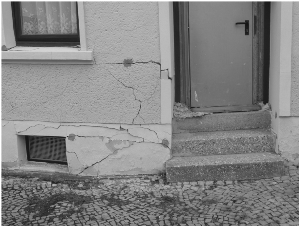
Bild 1.1 Risse an einem Wohngebäude infolge von Untergrundverformungen
