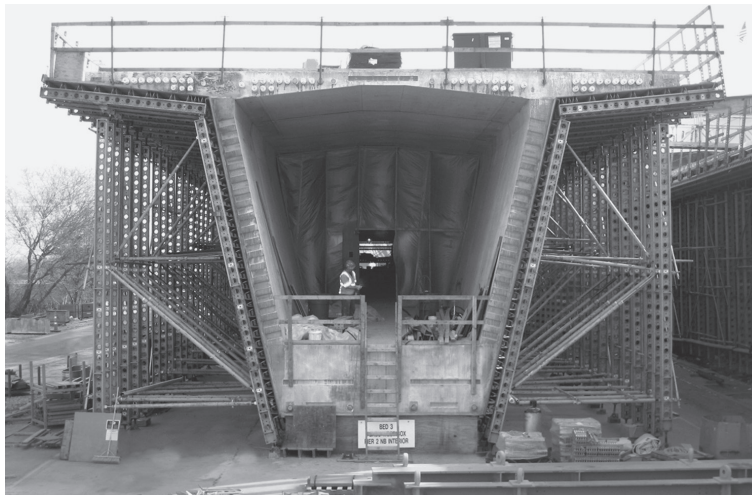
Segmentos precolados para el puente I-35 W en St Anthony Falls, Minneapolis, Minnesota. (Cortesía de EFCO Corporation.)
