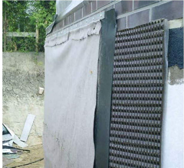
lose Kellerabdichtung: 3-lagige Abdichtungssystem aus dem Tankstellen- und Deponiebau, Dichtheitsprüfung vor Verfüllung der Baugrube
