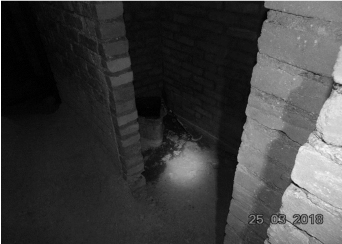
Auf dem Boden sieht man sehr gut die Zementschlämme
