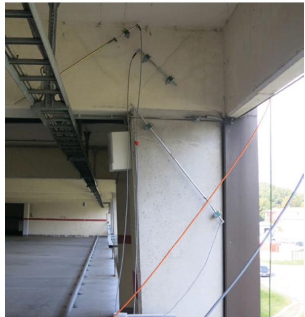
Abb. 17: Schubdehnungs- und Rissweitenmessung an hochbelasteten Rahmenecken
