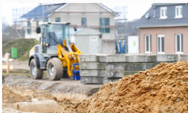
111 Mehr Sicherheit für unterirdische Infrastrukturen durch zentrales Auskunftsportal
