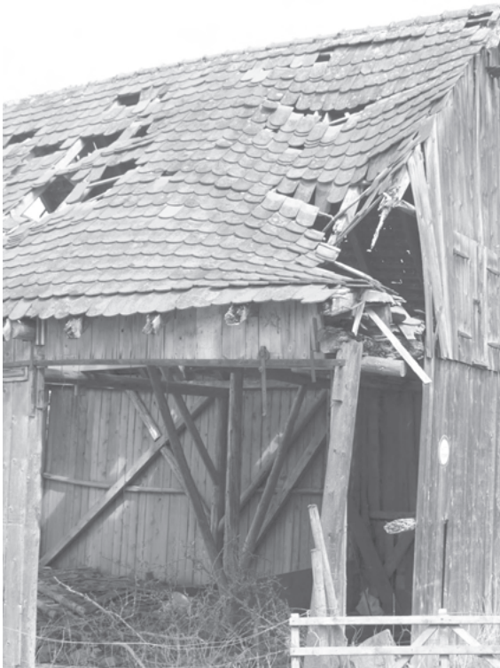
Abb. 3: Einsturzgefährdetes Gebäude – mögliche Gefahren gilt es zu verhindern (z. B. durch Absperungen oder Abriss, falls eine Sanierung nicht vorgenommen wird).
