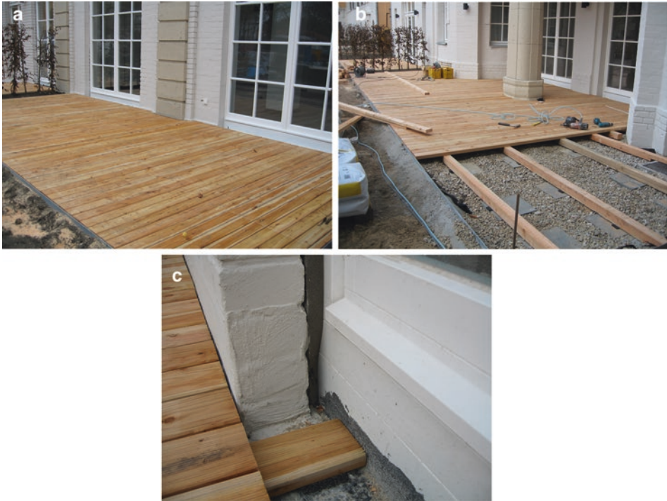
Abb. 2.1 a EG-Terrasse: Holzbohlen. b Auf Unterkonstruktion. c Fehlende Abdichtungsaufkantung
