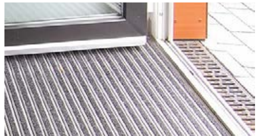
Ein schwellenfreier Hauseingang mit Wasserablauf außen und niveaugleich eingelassener Fußmatte innen.
