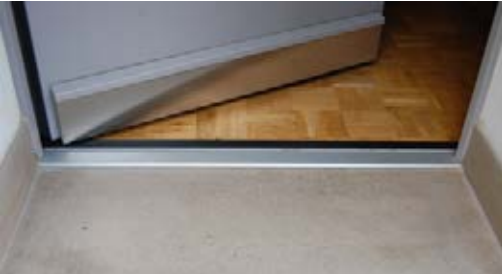
Neu eingebaute Haustür mit Schwelle niedriger als 2 cm.
