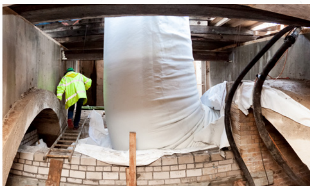
70 Dükersanierung im Doppeldüker in Leipzig, hier Inversion des Schlauchliners in die Südröhre
