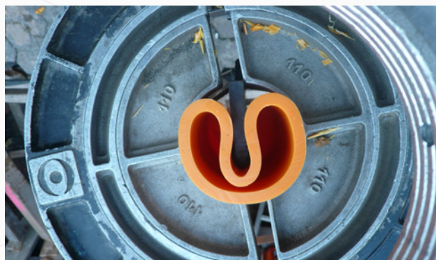
38 Grabenlose Verlegung von PE-Rohren im vorhandenen Gasrohrnetz in Prag mit dem Compact Pipe®-System
