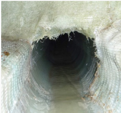
126 Mängel bei der Ausführung von Anbindungen sind leicht zu erkennen
