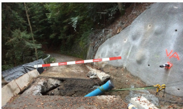
35 Berstling im Kanton Zug: auch in Schräglage sicher und effizient
