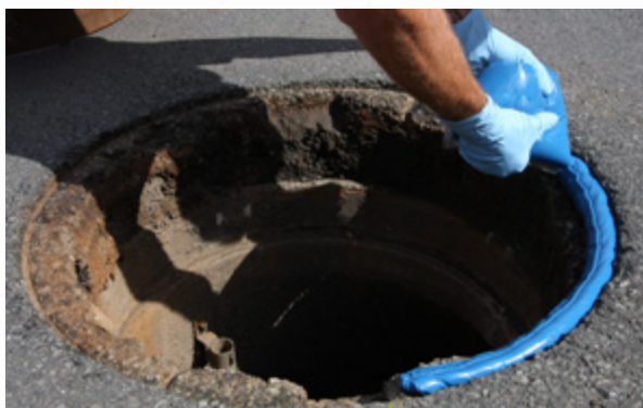
90 Dauerhafte Lösung gegen klappernde Schachtabdeckungen
