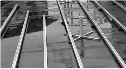
Bild 1. Wasserlachen auf einer Abdichtung einer Dachterrasse
