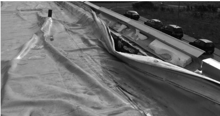
Bild 10. Nach einem Windergebnis mit Luftgeschwindigkeiten von 150 km/h wurde diese Dachabdichtung schwer beschädigt. Allerdings war der Dachaufbau fehlerhaft verklebt worden.
